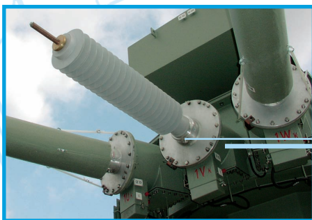
DTOI 123 kV – 1250 A
