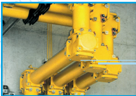
GL 12 kV – 2500 A
